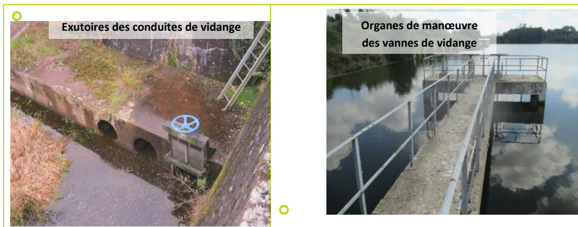
Figure 4 : Barrage de Pont-Avet - Photographie des exutoires de conduites de vidange et des vannes de vidange
